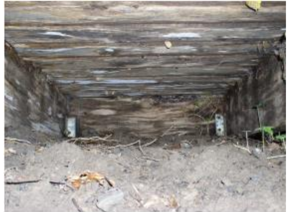
Querträger bereichsweise durchfeuchtet
